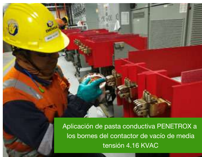
Mantenimiento de arrancadores de vacío de media tensión 4.16 KVAC, limpieza, ajustes de pernos, mediciones y pruebas de contacto
