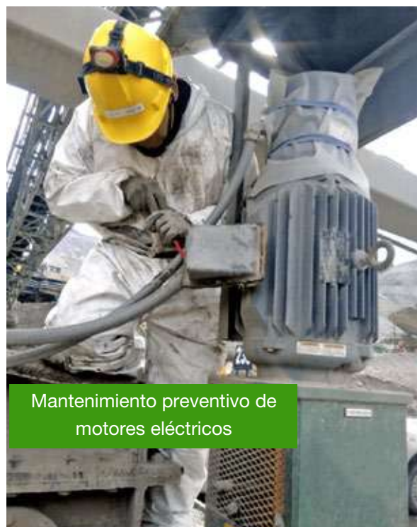
Mantenimiento de caja de conexión de motores eléctricos
